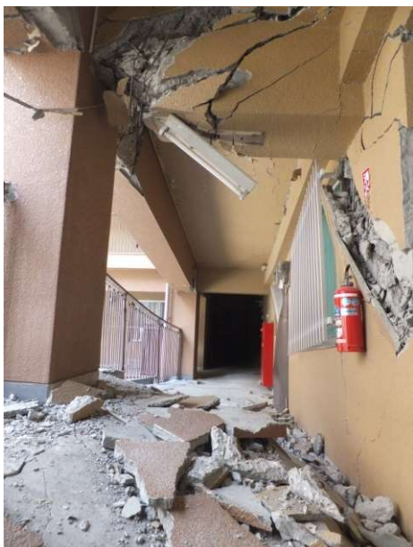
①柱・梁の損傷
