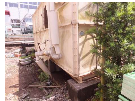
④受水槽の損傷
